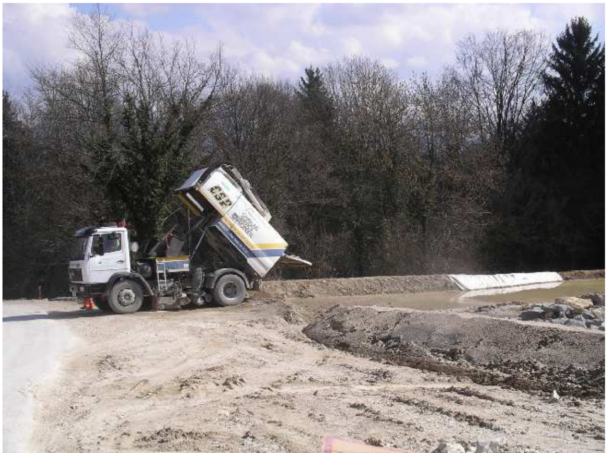
Photo 6 : bassin de vidange des engins de nettoyage de chaussées sur le bassin versant du ruisseau de la Ravoire
