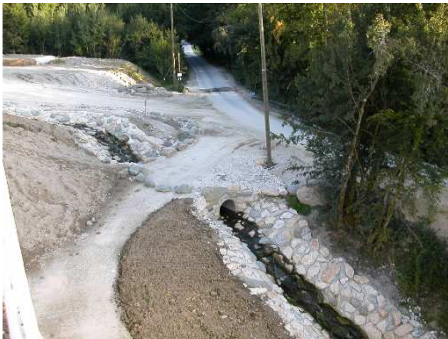
Photo 7 : Aménagement du franchissement du ruisseau de Bougy aval en aval de l'autoroute (juillet 2007)
