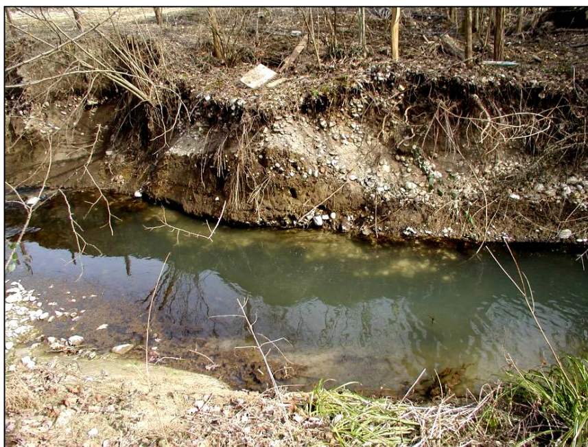
Figure 9 : Le Dadon, berge déstabilisée en rive droite
