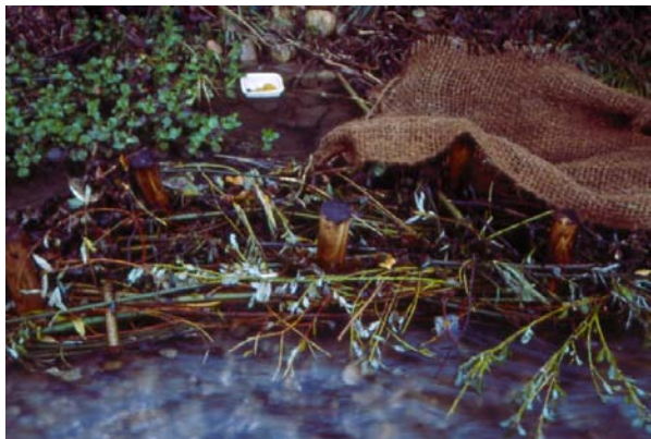
Mise en place d'une double rangée de pieux et d'un double tressage
