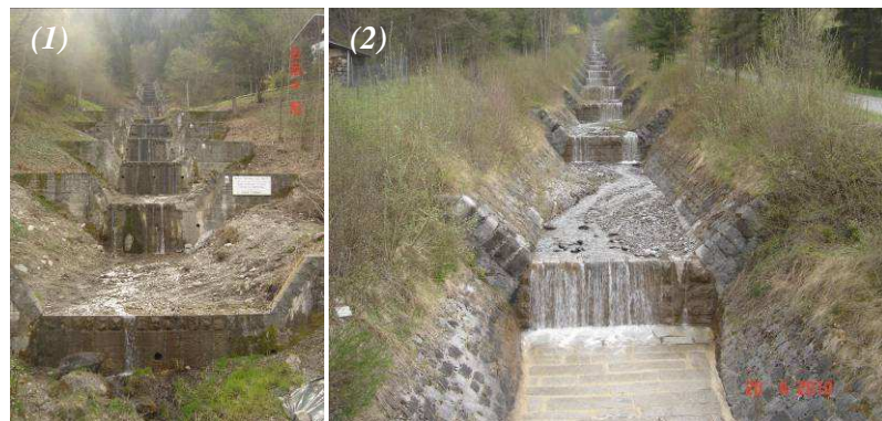
Figure 2 : Travaux de correction des profils en long pour la maîtrise des processus de transit sédimentaire : (1) Nant de la Ripaz, commune de Magland ; (2) Nant de Vernay, commune de Passy (Auteur : J-M Richardot, ONEMA 2010)
